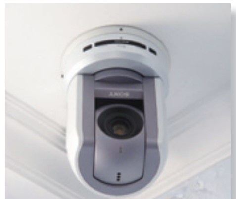
Видеокамера Sony BRC-300, установленная на потолке
